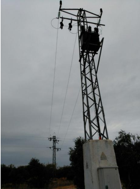
Poste que conecta con línea protegida
